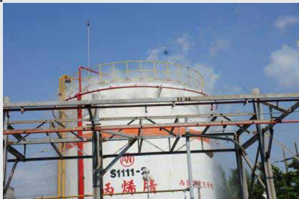
鄰近儲槽開啟自動撒水裝置隔離降溫
