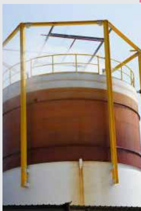
開啟廢BD回收槽自動撒水裝置
