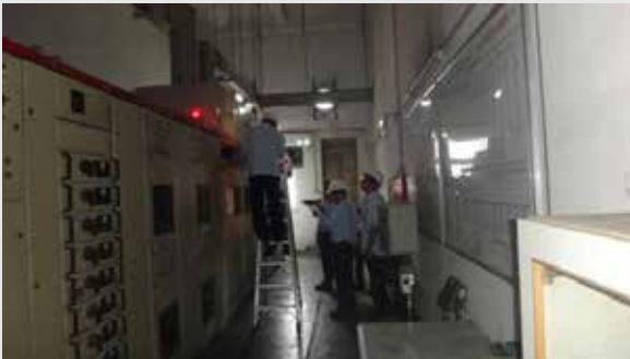
電氣人員排隊故障
