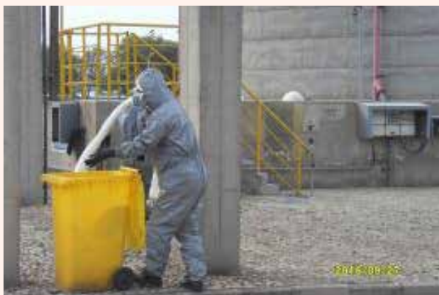
處置組使用吸油棉對洩漏區域進行圍擋。
