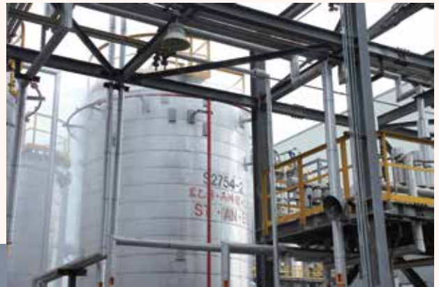
啟動儲槽自動撒水裝置。
