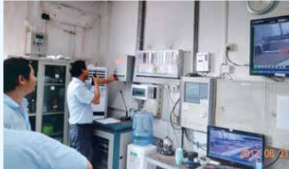
控制室火災氣體探測器報警
