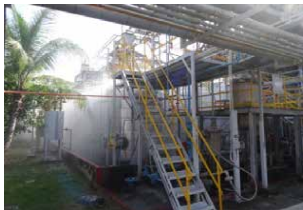
控制室立即啟動25區儲槽區灑水系統。
